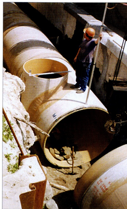
Conduite collecteur DN 2000
