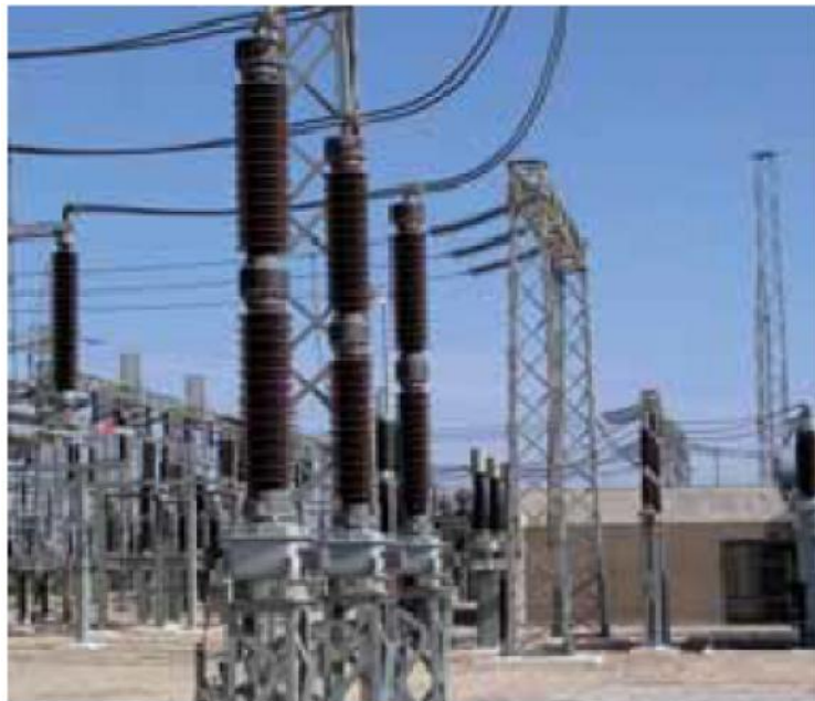
Transformateur capacitif de tension 245kV (NEPCO)
