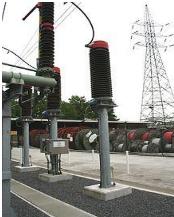
Figure II.3 Transformateur de tension, de tension nominale 150 kV.
