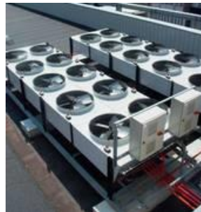
Figure 23 – Vue de condenseur à air [07]
